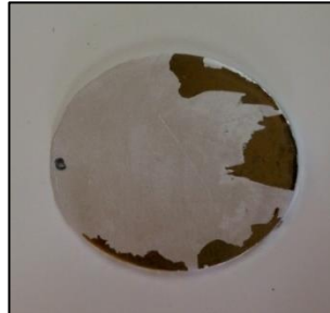
Gbr 4.6. Spesimen yang ter Korosi
